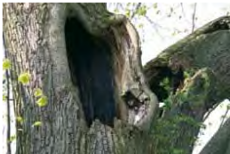
Beschädigte Äste an einer Sommer - Linde
